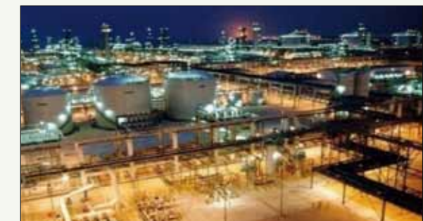
RAS LAFFAN PROJECT PHASE 6 & 7 Onshore LNG Plant
